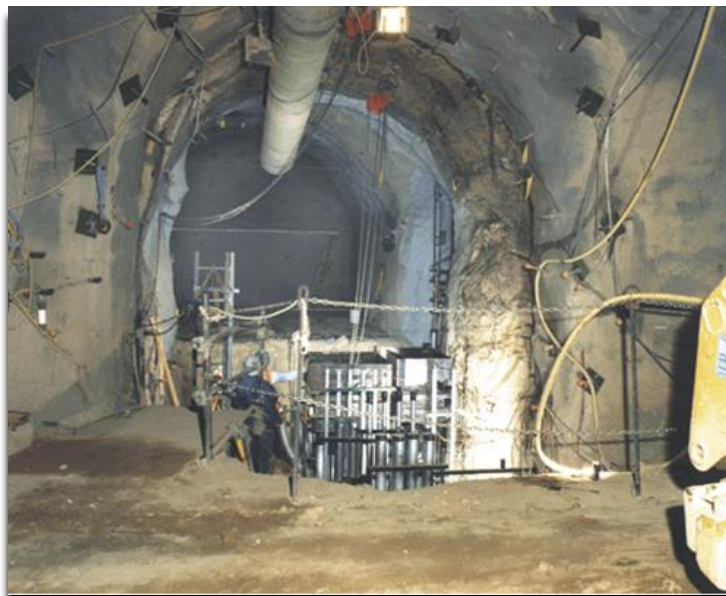
Uno de los nichos experimentales en el 102 minicomplejo durante la construcción. Los trabajadores están instalando las utilidades requeridas para el diagnóstico y pruebas subcríticas.
